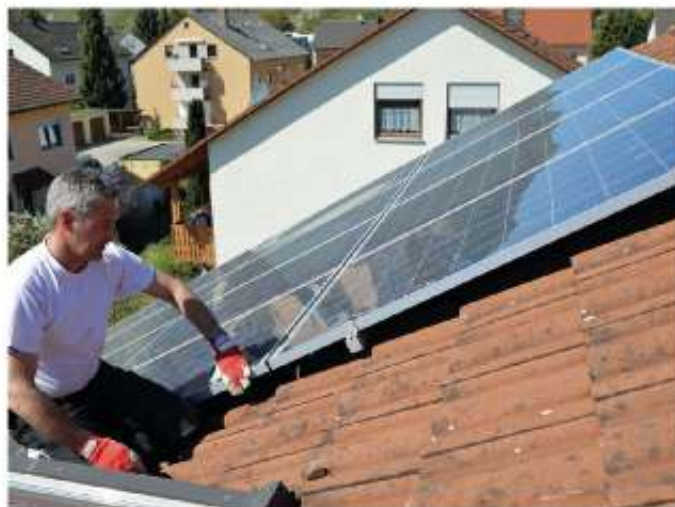
Auch die Begutachtung der Befestigungen von Solaranlagen gehört zum DachCheck. Foto: HF Redaktion/akz-o
