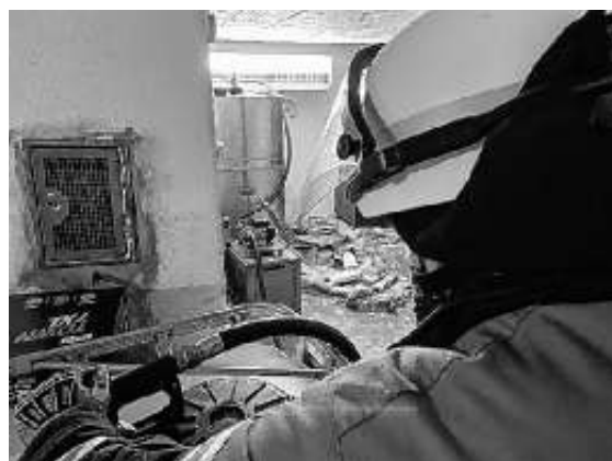
Umpumpen des Heizöls
